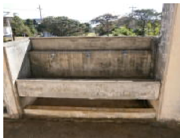
2階普通教室前水道
